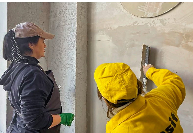
Neben der Theorie wird praktisch geübt. Drei Monate dauert die Ausbildung in Bauberufen an der Berufsfachschule.
