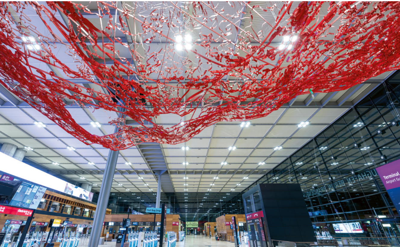
Die Deckenbeleuchtung im Terminal 1 wurde bis 2025 auf energieeffiziente LED-Technologie umgerüstet.
