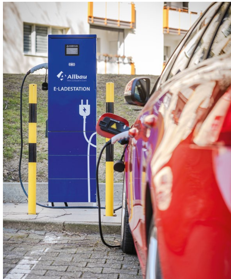
▲ Eine von zukünftig 100 Elektroladesäulen auf Allbau-Grundstücken.
