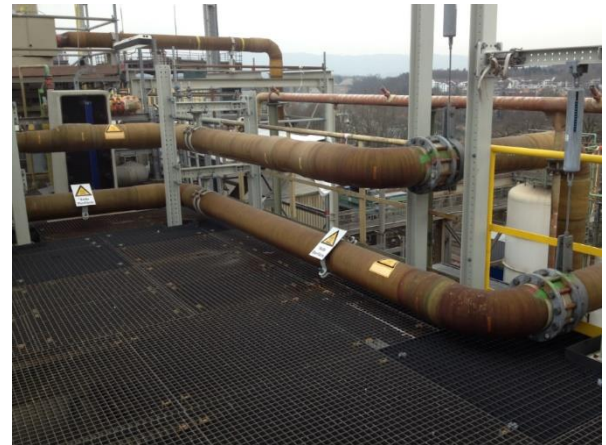
Heute: GfK mit geschweißtem Inliner
