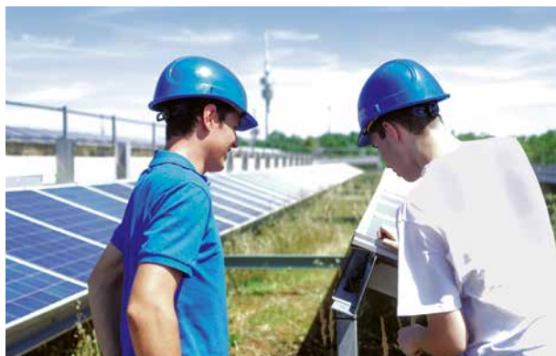
Mit Solarparks in der Region und Dach-Photovoltaik in der Stadt erzeugen wir lokal Ökostrom.
