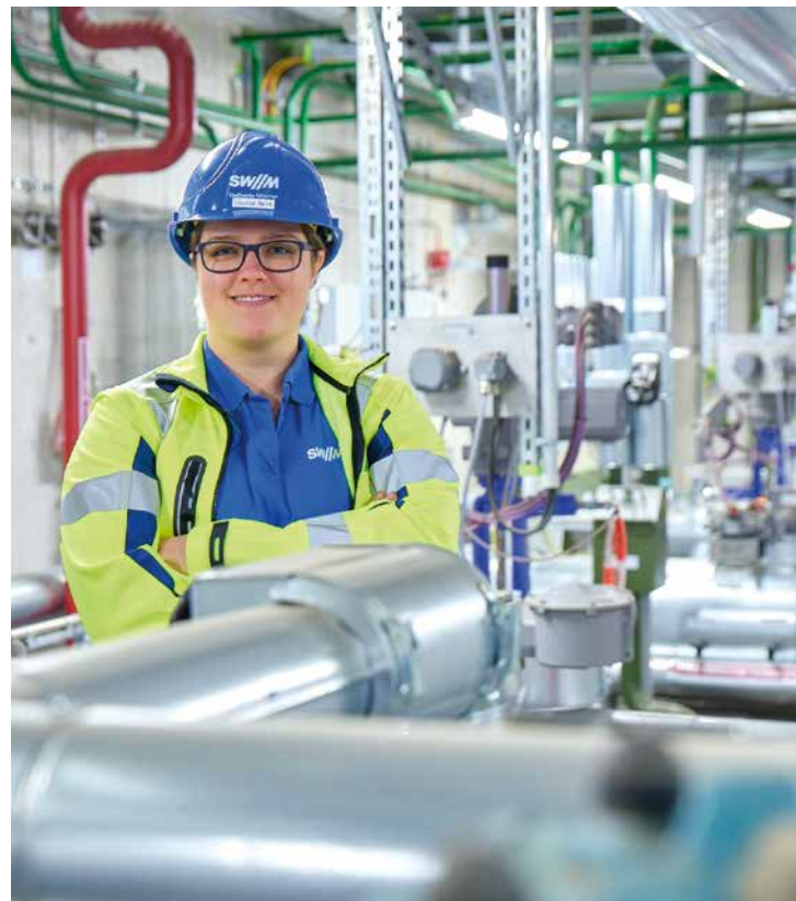
Wir nutzen Geothermie für klimaschonendes Heizen und Kühlen.
