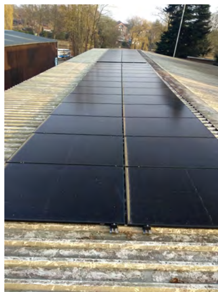
Photovoltaikanlage beim Ruderverein Teichwiesen
