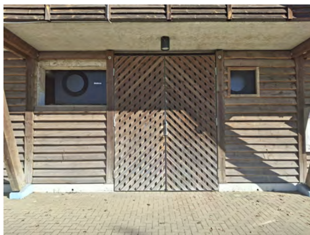
Wärmepumpe beim Ruder-Club Süderelbe
