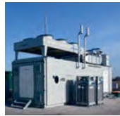
Haurup 1 MW Leistung, in Betrieb seit 2021
