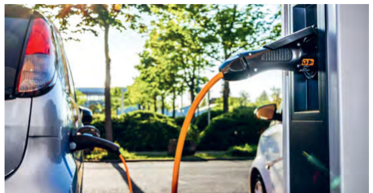
Bei Projekten zur Gebäudeversorgung wird auch das Thema E-Mobilität – hier eine Ladestation – mitgedacht.
