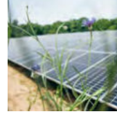
Roigheim 6,5 MW Leistung, in Betrieb seit 2022
