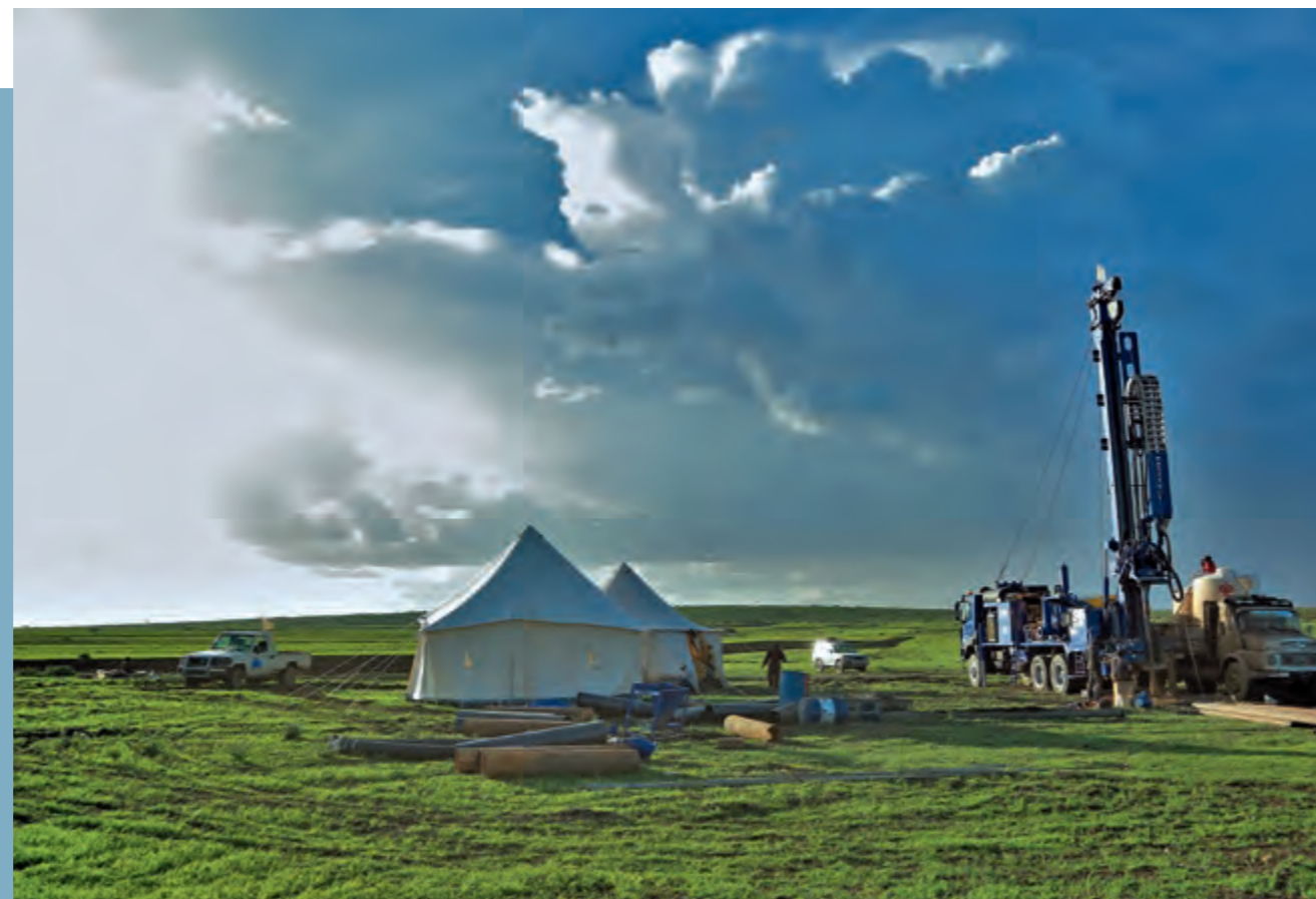
Das organisationseigene Tiefbohrgerät hatte bereits mehrere Einsätze, unter anderem im düregeplagten Somali. 4.500 Menschen sollen dort künftig mit sauberem Wasser versorgt werden.
