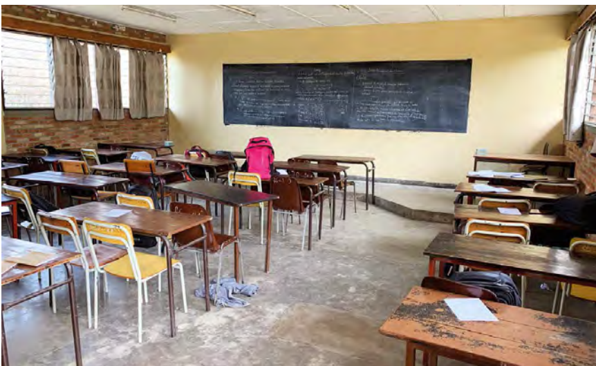
Spuren intensiver Nutzung: Die wegen der großen Nachfrage immer voll belegten Schulen sind stark renovierungsbedürftig. Geplant ist ein angenehmes Lernumfeld mit moderner Technikausstattung.
